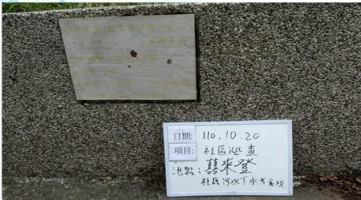
放流口告示牌標示不清楚
