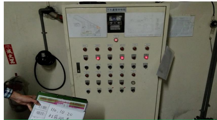
自動控制盤正常運作
