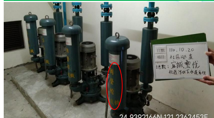
鼓風機確實標示名稱及正常運作
