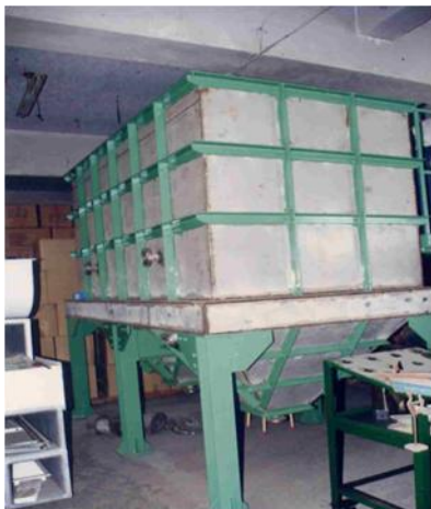
小型重力沉澱槽
