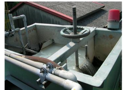
分水計量槽可迴流多餘進流水
