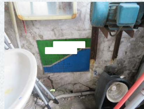
❌ 告示牌設置於周界內、 牌面底色非白色
