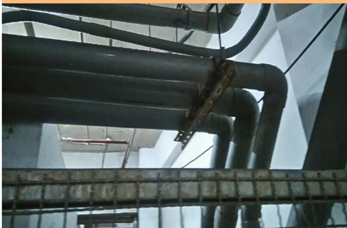
管線未標示名稱及流向
