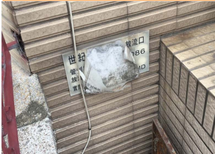
放流口告示牌破損
