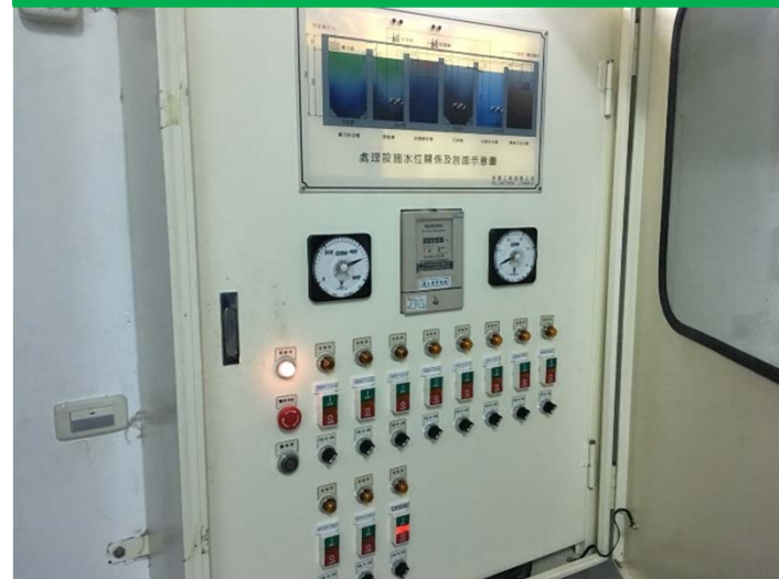
自動控制盤正常運作
