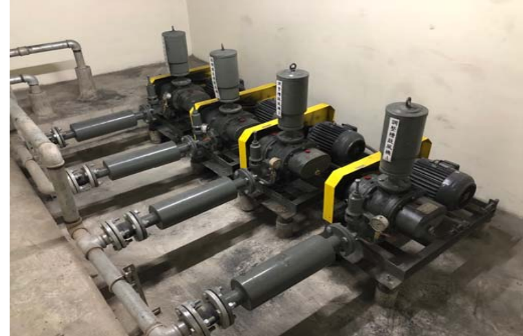
鼓風機確實標示名稱及正常運作
