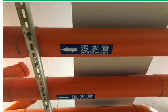
管線確實標示名稱及流向
