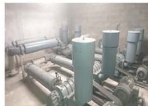
鼓風機房隔音措施
