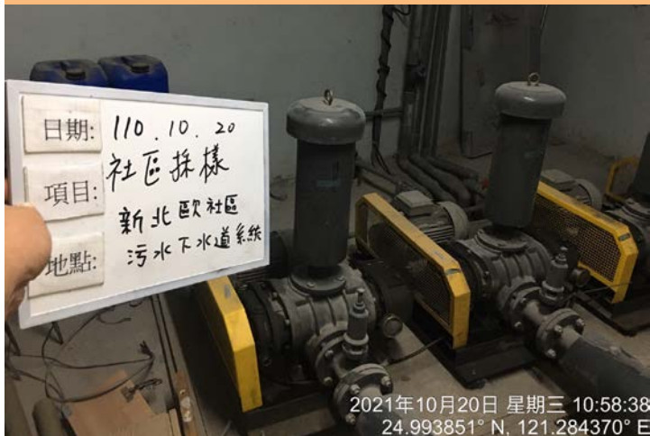
管線未標示名稱及流向
