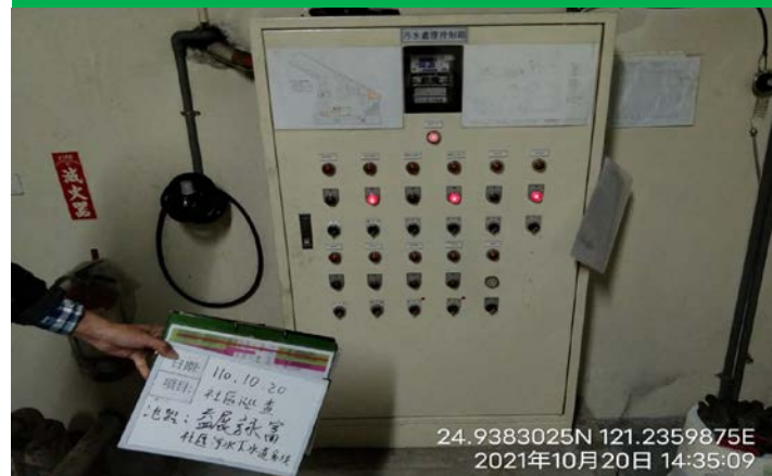
自動控制盤正常運作
