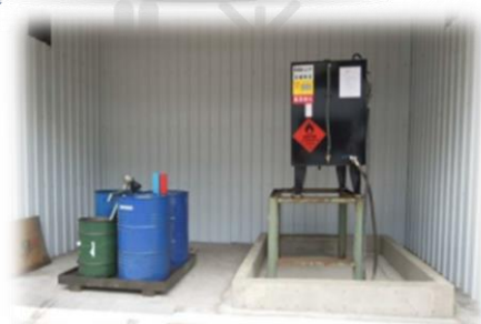
油品桶槽置於盛油盆上 油品儲槽週圍設置防溢堤
