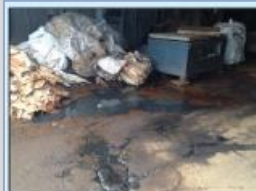
鋪面破損、污水遍地
