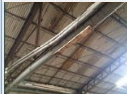
高架鉻酸管線破損
