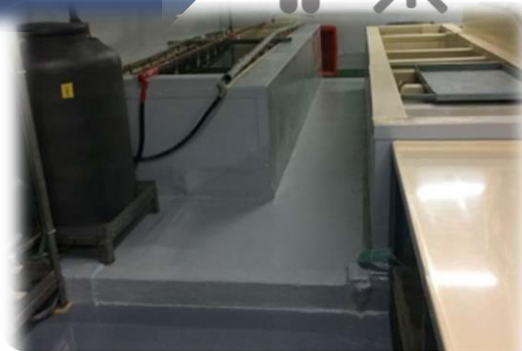
製程區設防溢堤 地表塗佈玻璃纖維(FRP)
