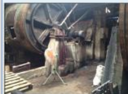
製程設備廢水滲漏
