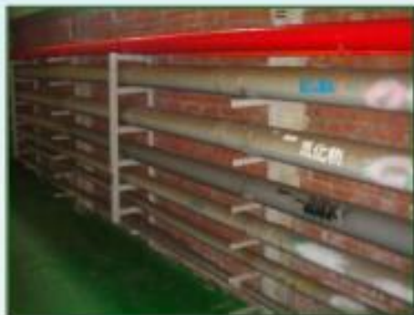
製程/廢水管線採用明管
