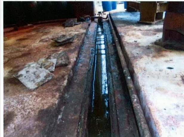
改善前(導水溝以水泥建構)
