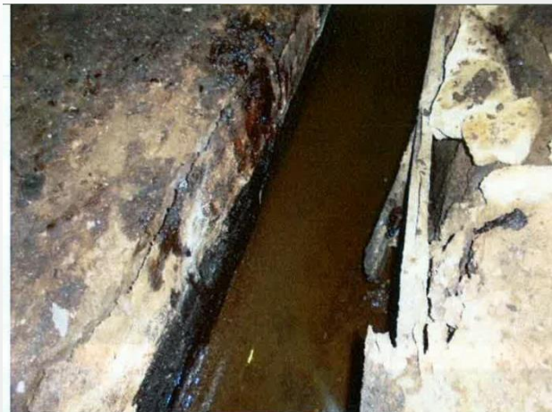
改善前(導水溝以水泥建構)
