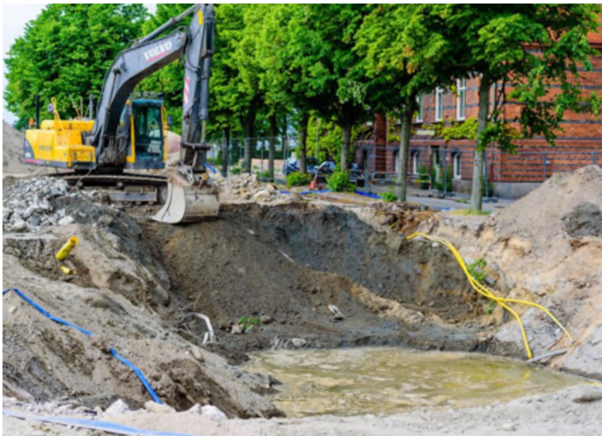
開挖之地下湧水
