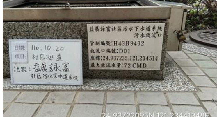
標示放流口告示牌
