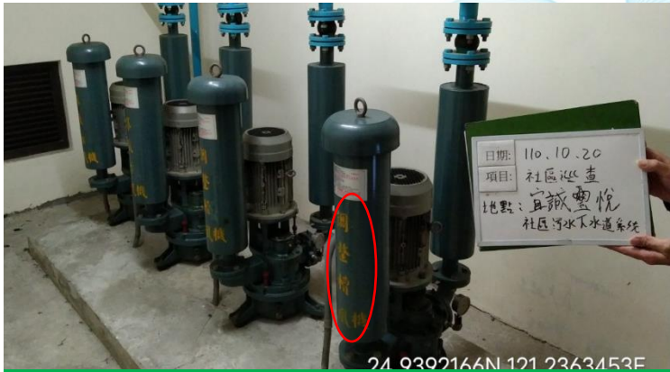
鼓風機確實標示名稱及正常運作
