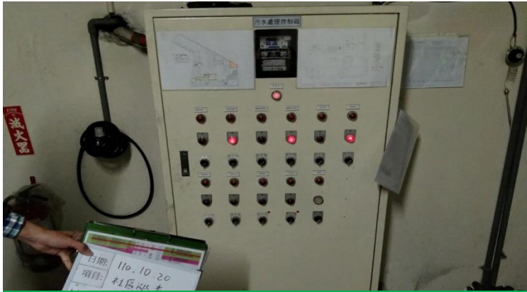
自動控制盤正常運作
