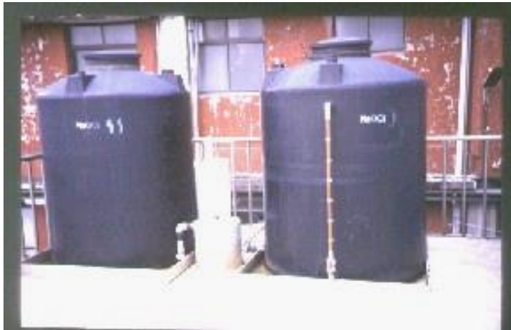
防溢堤容積不足
