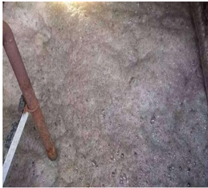
活性污泥槽曝氣
