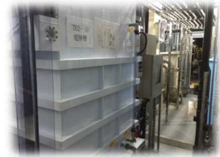
電解氧化實廠設備
