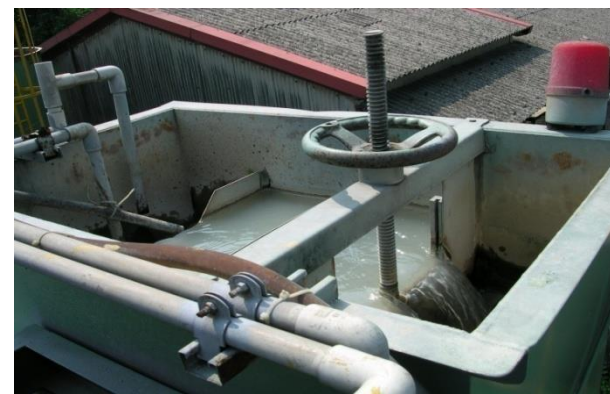
分水計量槽可穩定進流廢水量
