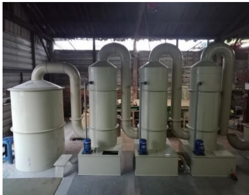
氨氮氣提、氯化銨循環回收設備
