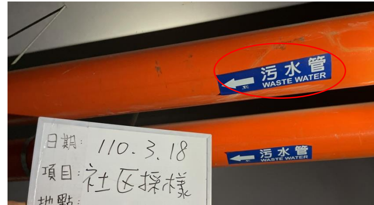
管線確實標示名稱及流向
