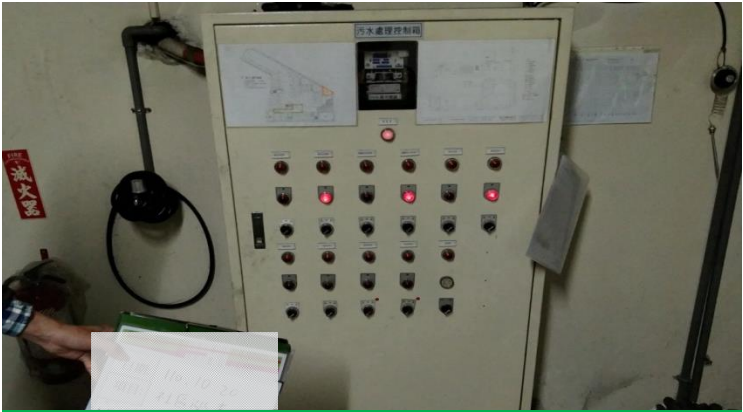
自動控制盤正常運作
