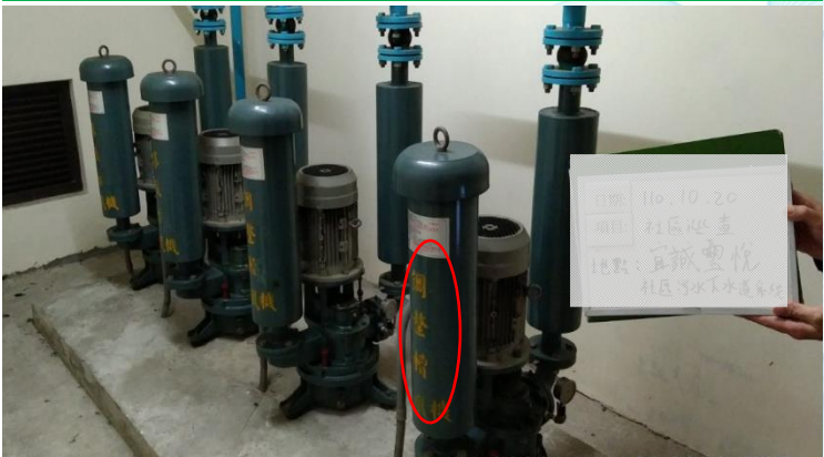
鼓風機確實標示名稱及正常運作
