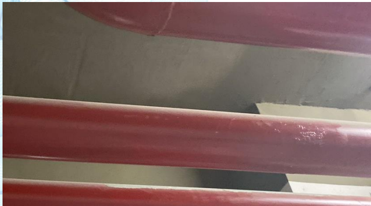
管線未確實標示名稱及流向
