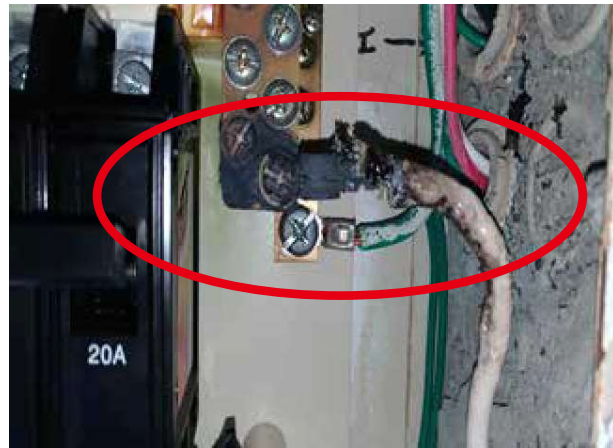
(b) 內部電線異常
