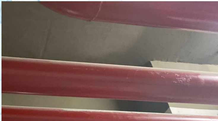
管線未確實標示名稱及流向
