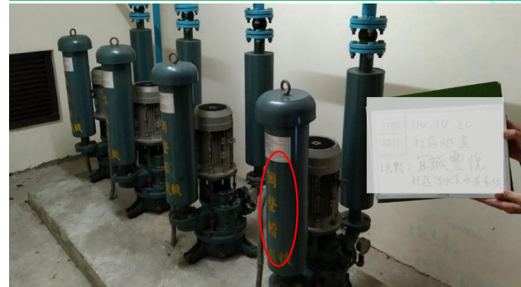
鼓風機確實標示名稱及正常運作
