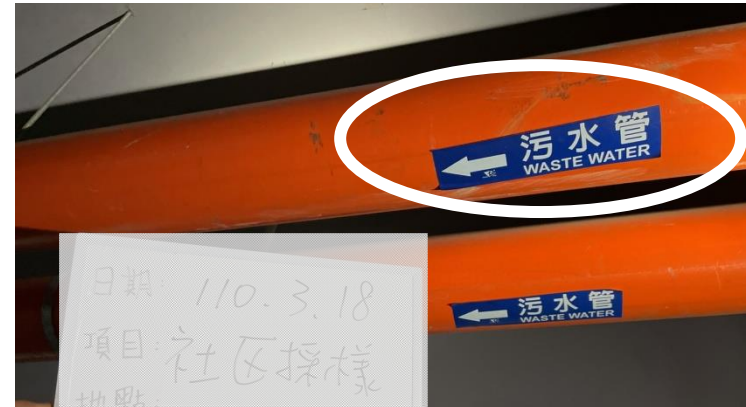
管線確實標示名稱及流向
