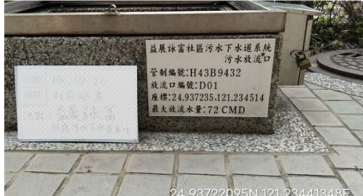
標示放流口告示牌
