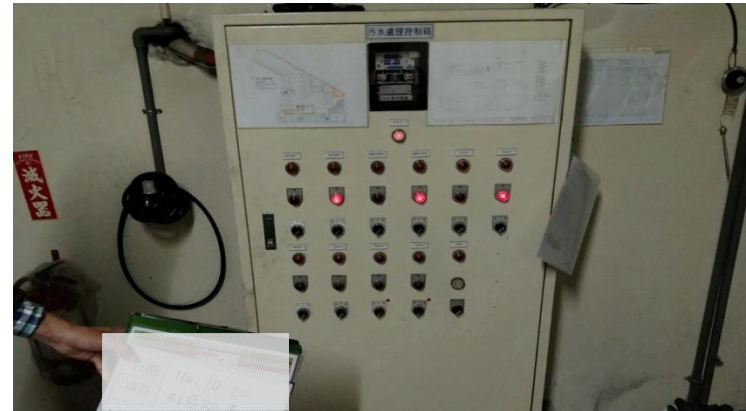
自動控制盤正常運作
