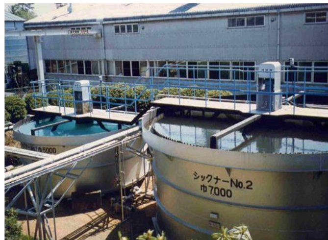
大型重力沉澱槽
