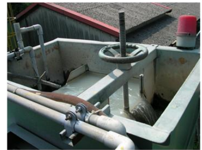
分水計量槽可迴流多餘進流水
