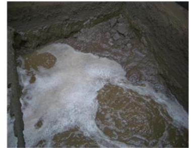
貯槽底部沉積大量污泥
