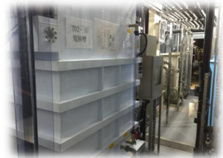
電解氧化實廠設備
