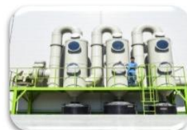
氣提循環設備
