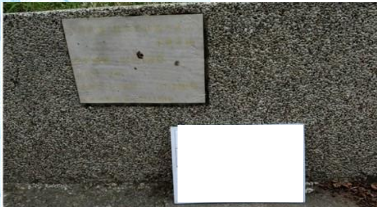
放流口告示牌標示不清楚
