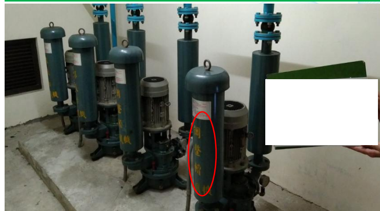
鼓風機確實標示名稱及正常運作
