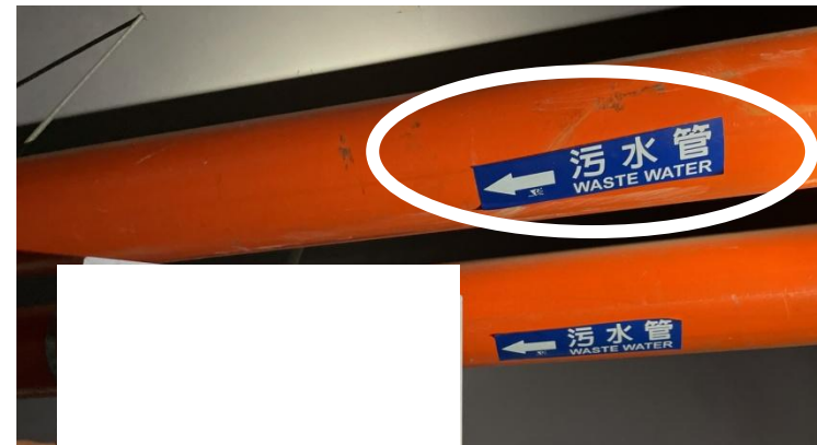
管線確實標示名稱及流向
