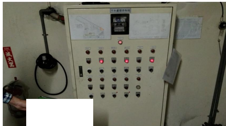
自動控制盤正常運作
